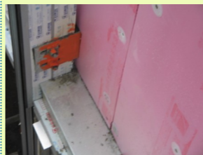
图4: 幕墙保温板及防火带
