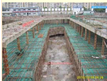
上图均为全封闭防护棚
