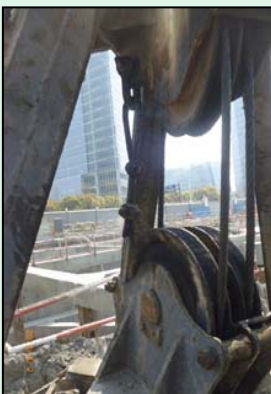
上图为抓铲挖掘机钢丝绳U型卡安装反了且少一个U型卡
