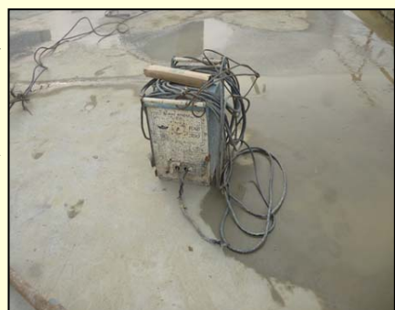
上图中电焊机无二次空载降压装置且一次侧电源线及二次接线桩头无防护罩
