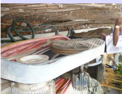
空压机传动皮带防护罩防护网破损，未及时维修或更换
